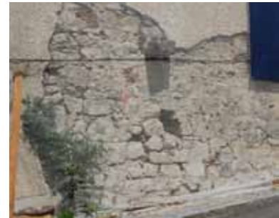
Schäden beider Einfriedungsmauer; Foto: Manfred Danner
